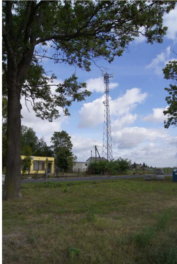
Fot. 14 Stacja bazowa telefonii komórkowej w Jasieniu Fot. własna
