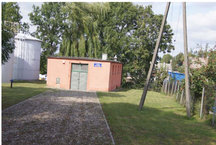
Fot. 13 Gminne ujęcie wody w Tłuchowie
